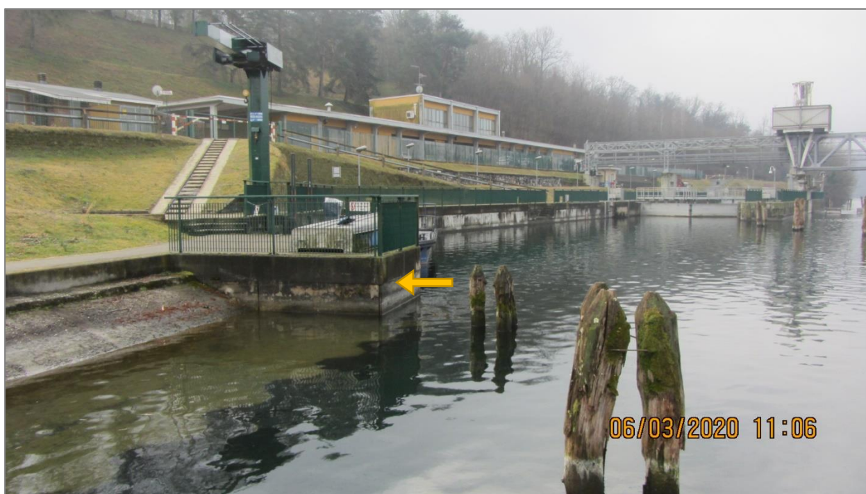
Figura 7: Vista dal molo flottante del sito di installazione della stazione Miorina
